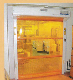
▲施工例(食品工場)
